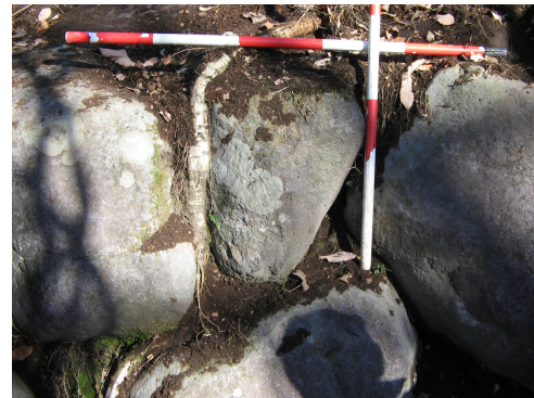
堤体の変形（樹木の侵入）
