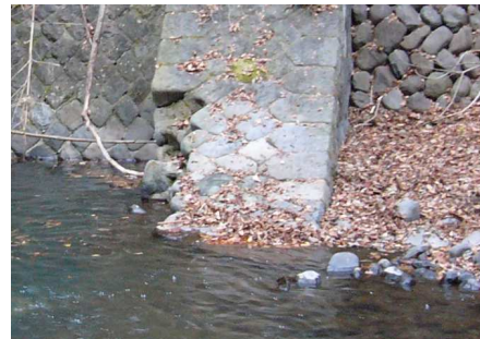
袖部上流側の石積の欠落
