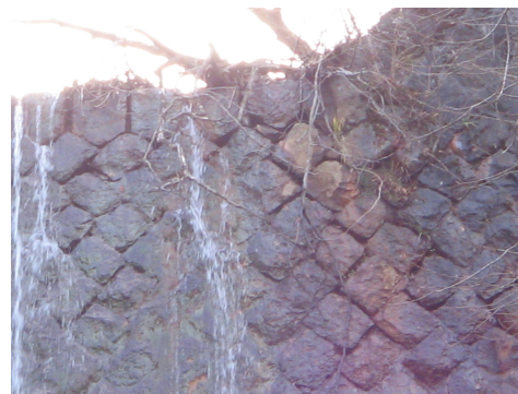
合端コンクリートの欠損
