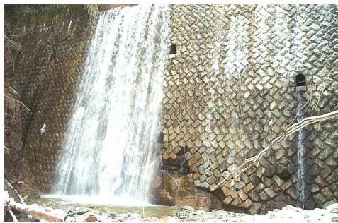
堤体基礎部の洗掘
