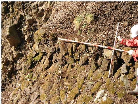
石積押し出しと欠落
