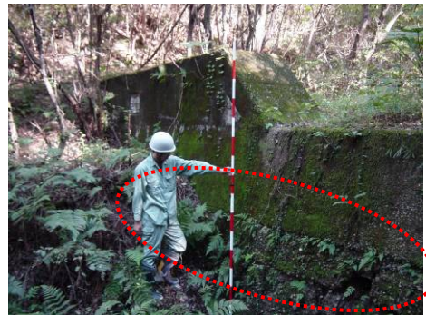
打ち継目亀裂に沿った風化・欠落 下流のり面に, 打ち継目亀裂に沿って風化・欠落が生じている。
