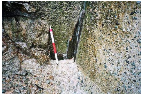
下流のり面の磨耗状況 越流水の衝撃により下流のり面のコンクリートが磨耗され、豆板状に粗骨材が露出している。
