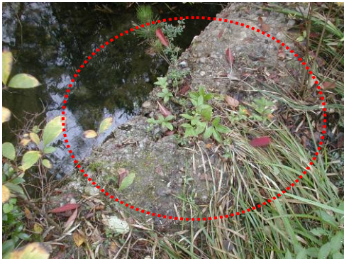
水通しの磨耗状況 越流水により水通し部コンクリートが磨耗され、豆板状に粗骨材が露出している。
