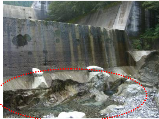
基礎の洗掘状況 破砕帯にそって洗掘が進んでいる。
