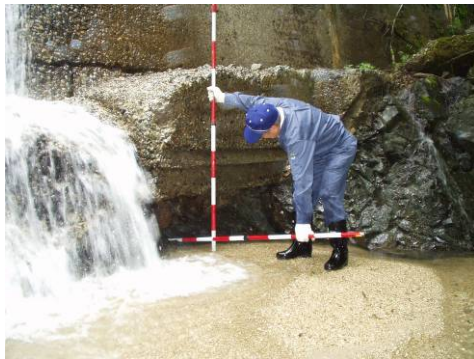
基礎の洗掘状況
