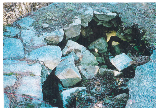
天端の陥没（中詰の吸出し）
