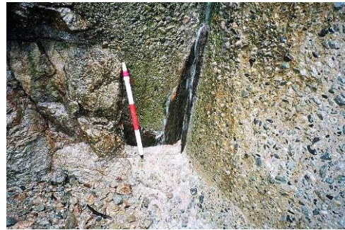
下流のり面の磨耗状況 越流水の衝撃により下流のり面のコンクリートが磨耗され、豆板状に粗骨材が露出している。
