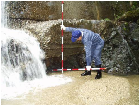
基礎の洗掘状況
