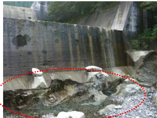
基礎の洗掘状況 破碎帯にそって洗掘が進んでいる。
