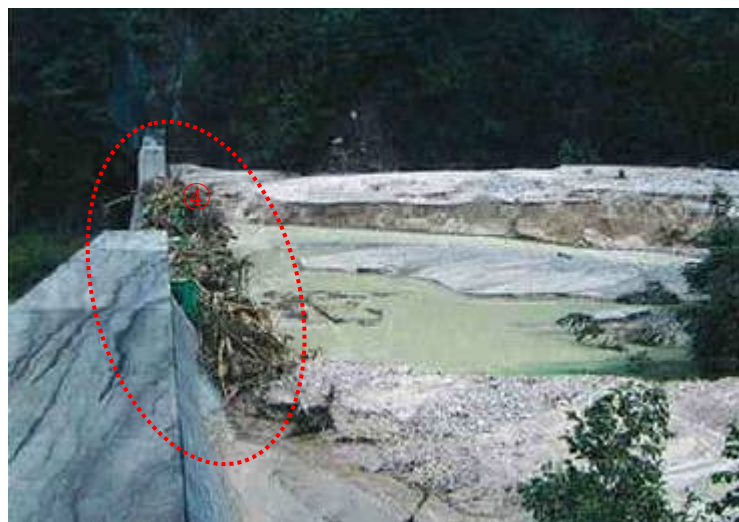
主堰堤(流木止め)が流木を捕捉したままの状態 (本谷第8砂防堰堤)
