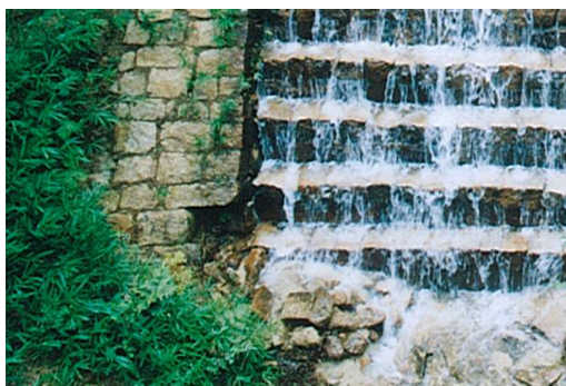
堤体基礎部の石積の欠落
