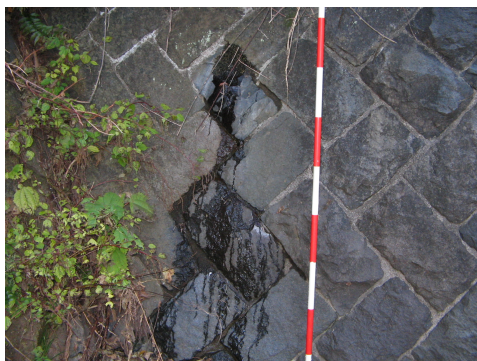
堤体表面からの漏水
