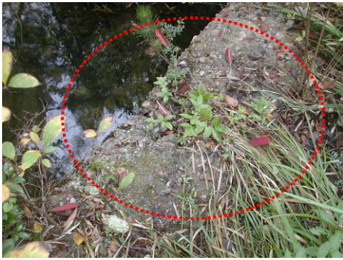
水通しの磨耗状況 越流水により水通し部コンクリートが磨耗され、豆板状に粗骨材が露出している。
