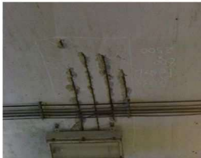
付写真-3.1.2 鋼材腐食の例
